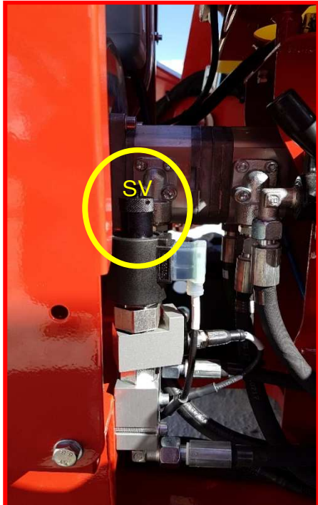
Figure 27 : vanne des stabilisateurs.
