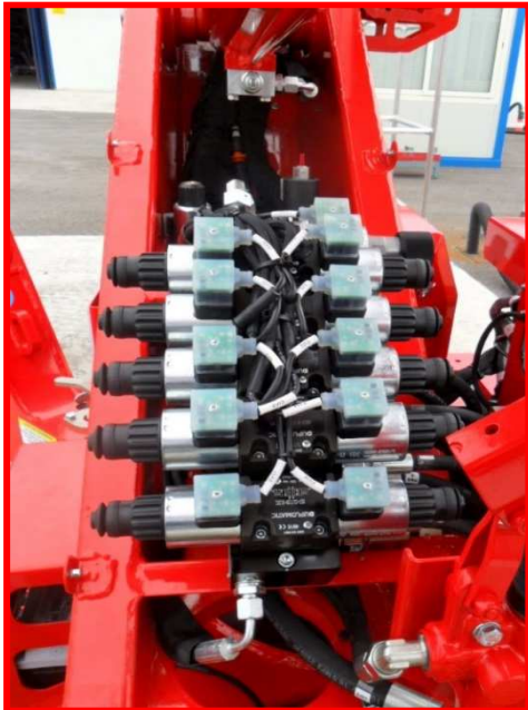
Figure 15 : banc vanne poste d'urgence.
