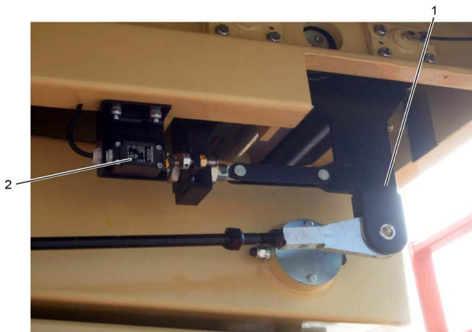
Un des leviers de sécurité anti-surcharge avec interrupteur
